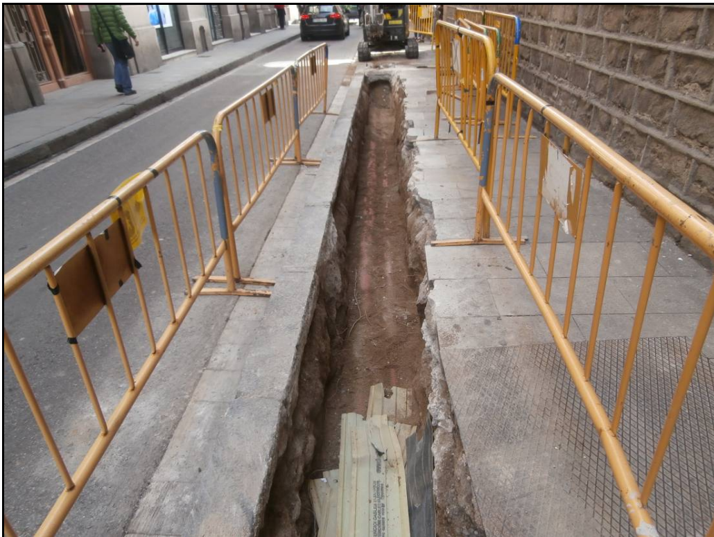
Fotografia 4: Trobament del tubs de la línia elèctrica a la mateixa Rasa 2.
