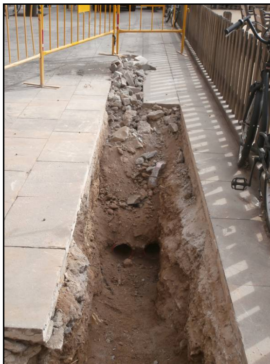
Fotografia 2: Tubs buits al carrer Floristes de les Rambles, a la cala de comprovació.
