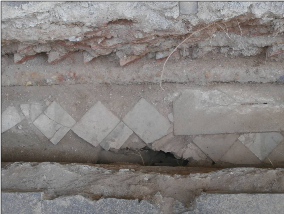
Fotografia 9: Detall dels serveis elèctric (a dalt) i de gas (a sota) que afectaven les estructures arqueològiques.
