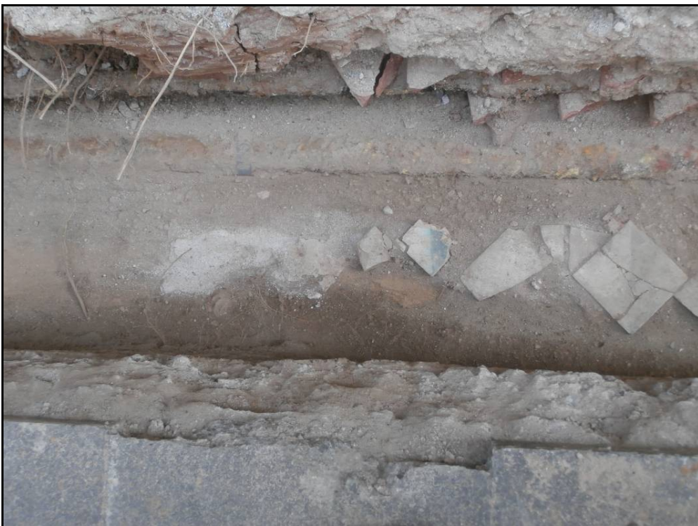
Fotografia 10: Desaparició del paviment amb les restes de morter de la seva sustentació.
